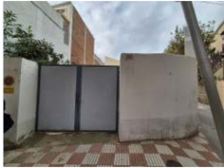
02_zona afectada façana a Passeig Riera,63.
