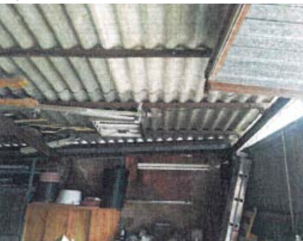
08.estructura de fibrociment tòxica a enderrocar
