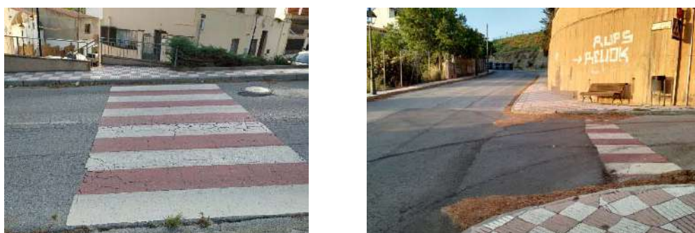
Figura 44.– Detall de pas de vianants sense guals rebaixats i en mal estat de manteniment. Font: elaboració pròpia
